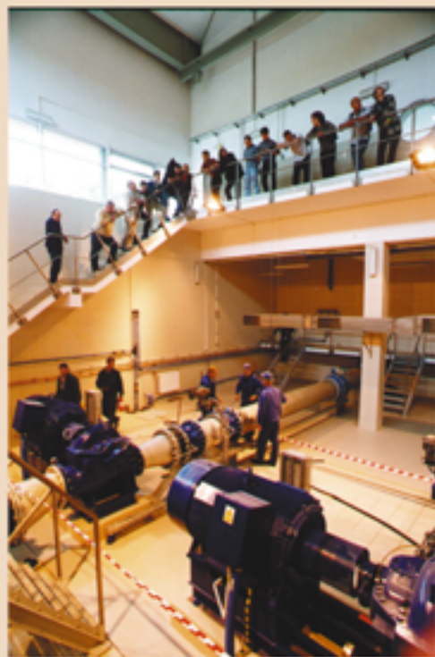
Nowa pompownia wody czystej (otwarta w br.)
