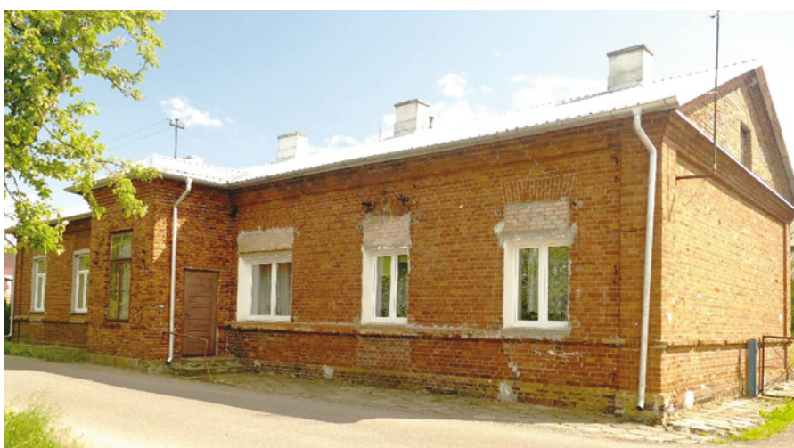
Il. 16. Sokoły – budynek tzw. dworca na szlaku Łapy–Ostrołęka, z otworami okiennymi obniżonymi i dostosowanymi pod względem kształtu do nowych, plastikowych okien. Stan w 2020 r. (fot. A. Oleksicki)
