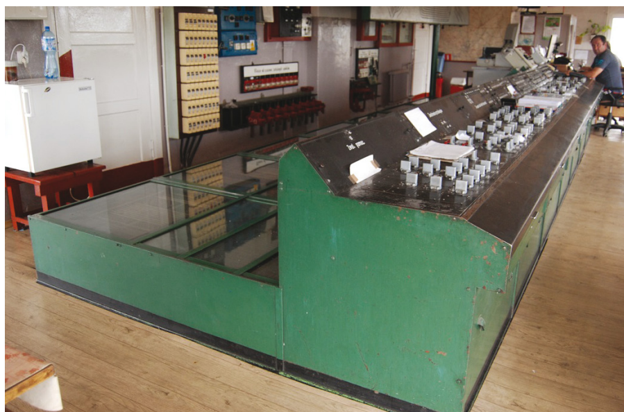
Il. 5. Nastawnica suwakowa czterorzędowa z 1943 r., poziom górny (Iława). Stan w 2012 r. (fot. P. Mierosławski)
