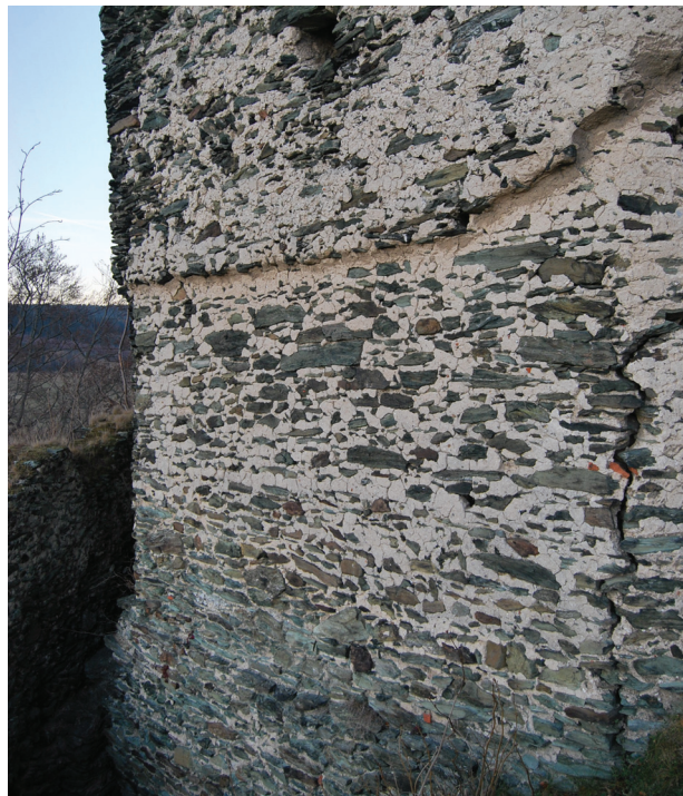
Il. 6. Bruzda po ganku bojowym widoczna w licu południowo-zachodniego boku wieży, na wysokości trzeciej kondygnacji (fot. P. Błonieński)
