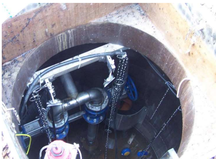
Rys. 4.3 Widok wnętrza pompowni z dwoma pompami tłocznymi.
