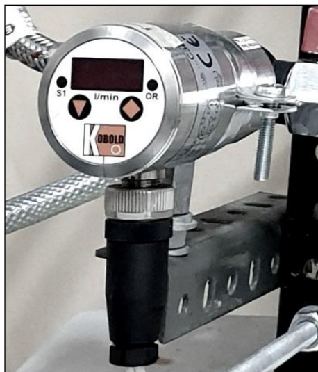
Rys. 5.4. Widok wykorzystanego przepływomierza wody
