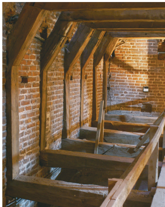
197. Wnętrze strychu nad prezbiterium z widokiem na ścianę wieży (patrz 196.A), stan z 2007 r. (fot. E. Łużyńska)
