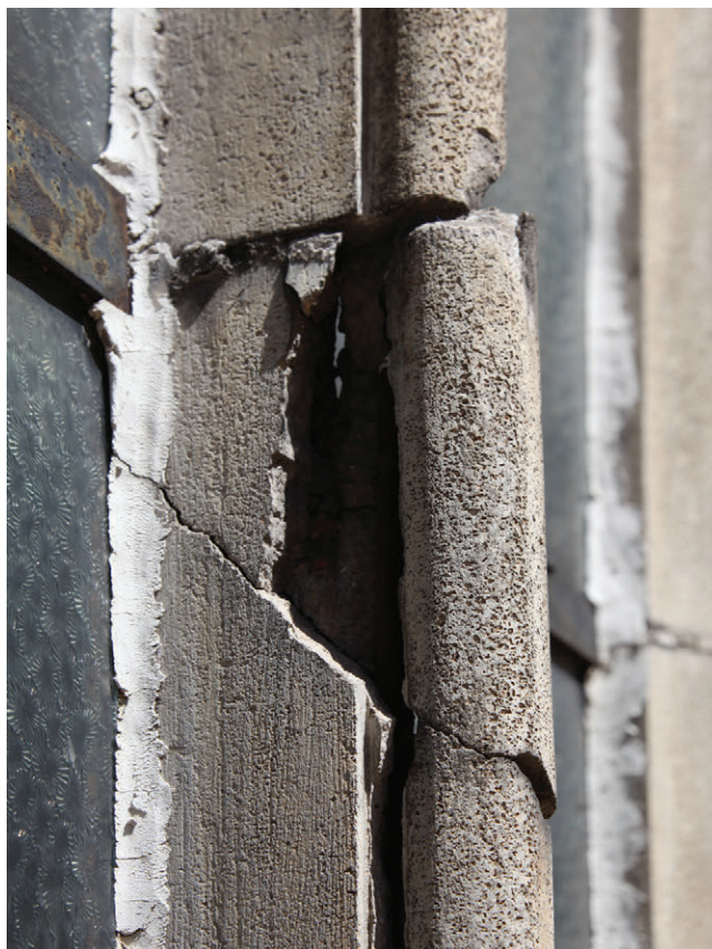
64. Fragment zbrojenia widoczny w lasce maswerku, stan z 2010 r. (fot. E. Łużyńska)
