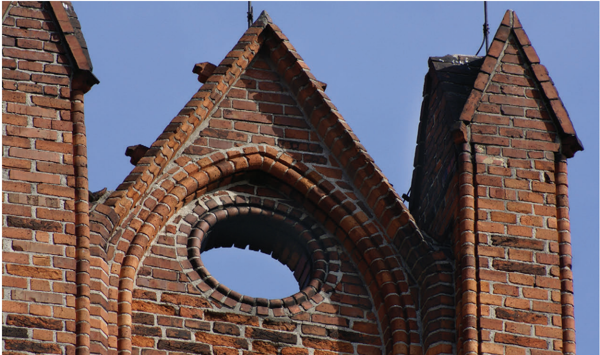
54. Fragment sterczyny szczytu zachodniego nawy głównej, stan z 2010 r. (fot. E. Łuzyniecka)
