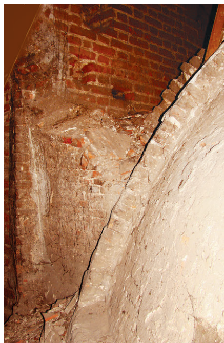
193. Osadzenie powłoki sklepienia kaplicy św. Jacka widoczne we wnętrzu strychu, stan z 2007 r. (fot. E. Łużyńska)
