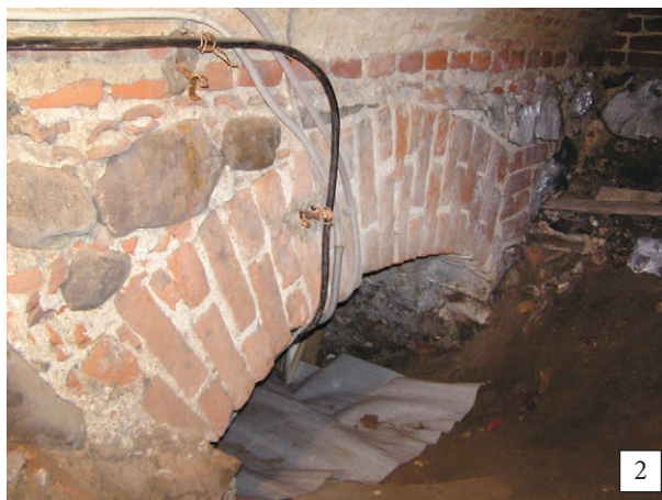
122. Łęk fundamentu północnego prezbiterium we wnętrzu kanału (patrz 104.4): 1 – inwentaryzacja (oprac. ZWA PWŕ), 2 – widok, stan z 2004 r. (fot. E. Łużyniecka)
