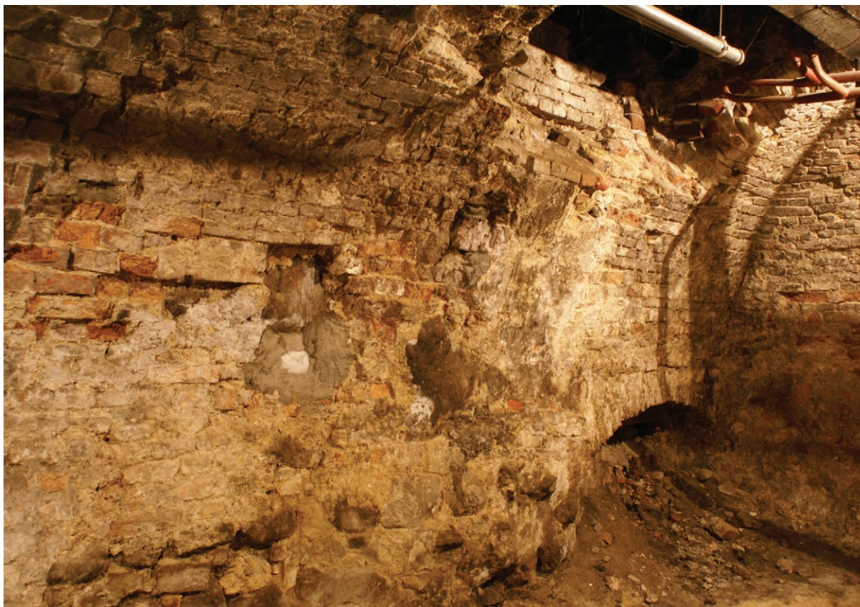
117. Widok styku ściany zachodniej ze ścianą północną kotłowni (patrz 104.3), stan z 2004 r. (fot. E. Łużyńska)
