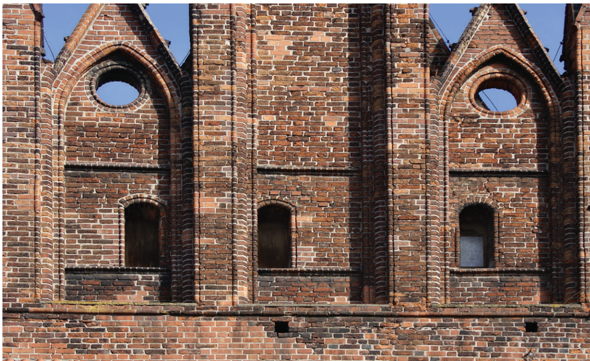
52. Okna strychu szczytu zachodniego nawy północnej, stan z 2007 r. (fot. E. Łużyniecka)
