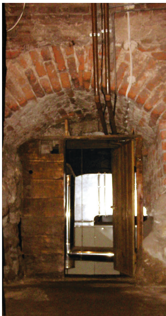
110. Łęk w ścianie wschodniej łącznika wykorzystany jako zwieńczenie przejścia (patrz 104.2), stan z 2004 r. (fot. E. Łużyńska)
