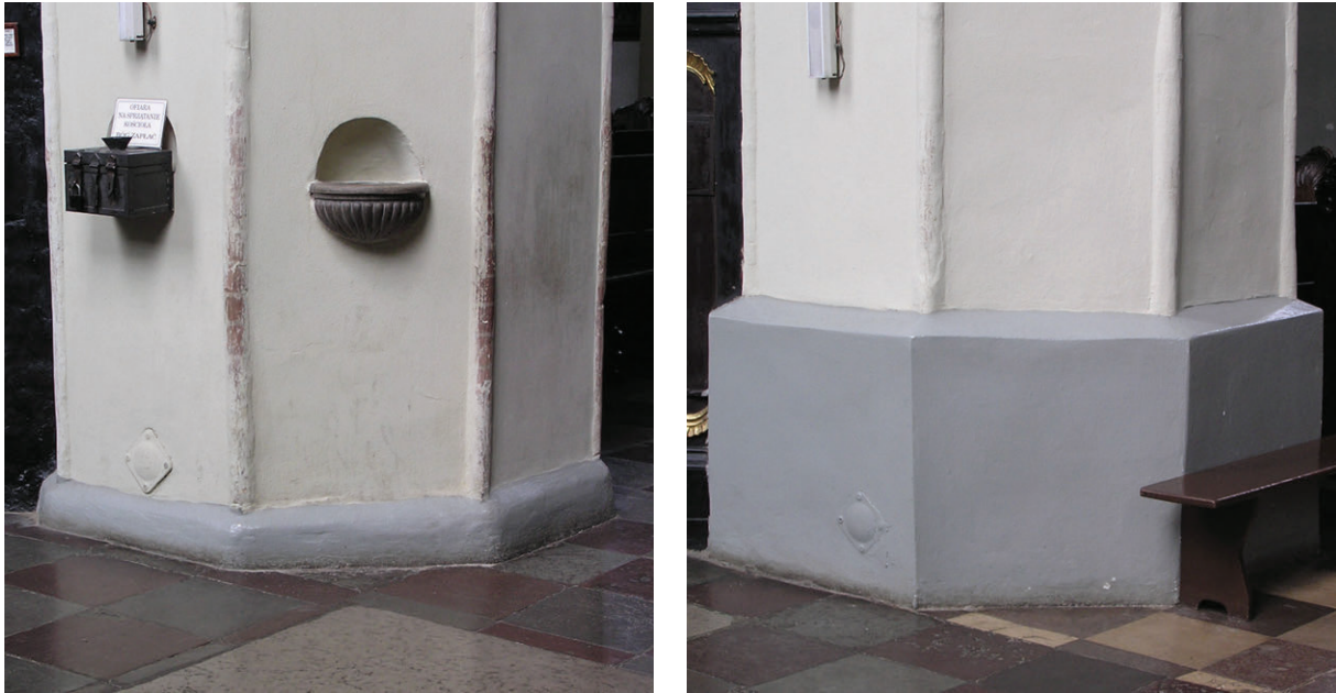
161. Zróżnicowana wysokość baz filarów międzynawowych, stan z 2007 r. (fot. E. Łużyńska)
