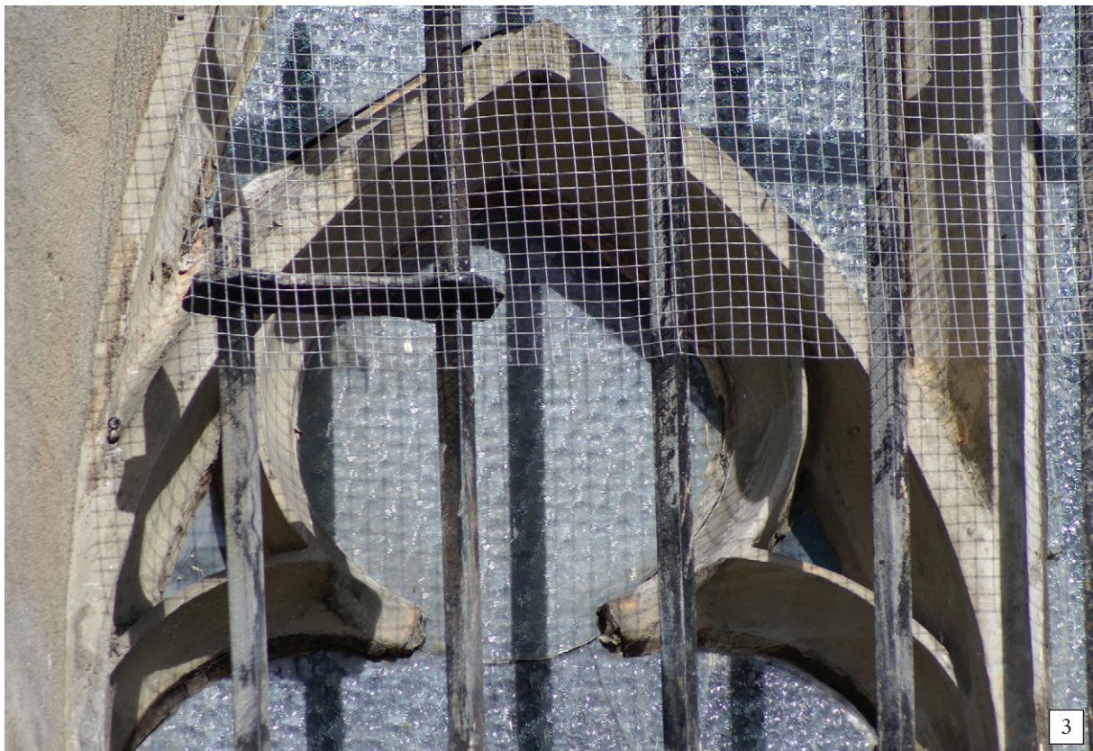
70. Okno południowe kaplicy św. Józefa: 1 – z piętnem wieży, 2 – górna część maswerku, 3 – betonowy odlew górnej części maswerku, stan z 2007 r. (fot. E. Łużyńska)
