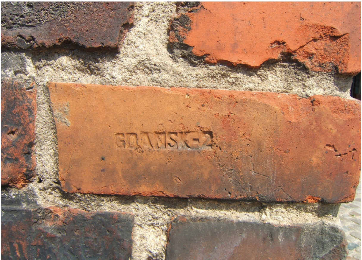
82. Napisy umieszczone na ceglach w części cokołowej ściany południowej nawy bocznej, stan z 2007 r. (fot. E. Łużyniecka)
