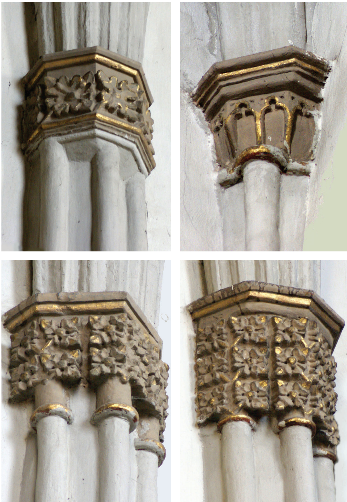
141. Kapitele wiązek słupów w ścianie południowej, stan z 2007 r. (fot. E. Łużyńska)
