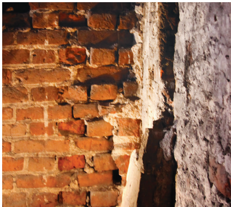
194. Wiązanie ściany prezbiterium z murem szczytu (?) pomieszczenia zlokalizowanego pierwotnie w miejscu kaplicy św. Jacka, stan z 2007 r. (fot. E. Łużyńska)
