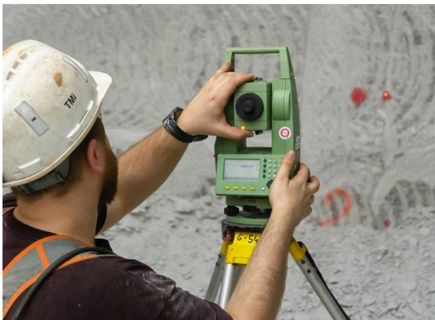
Rysunek 6. Pracownik obsługujący tachimetr przeprowadza pomiar bezlustrowy do środka namalowanego koła – punktu stanowiącego miejsce pomiaru konwergencji.
