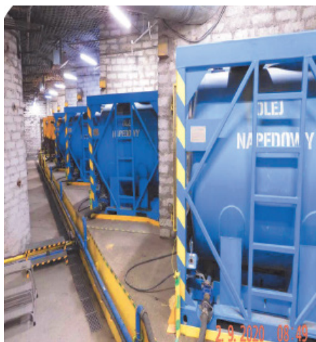
Rycina 2. Zbiorniki na materiały rafineryjne przyłączone do wewnętrznej instalacji w komorze paliw
