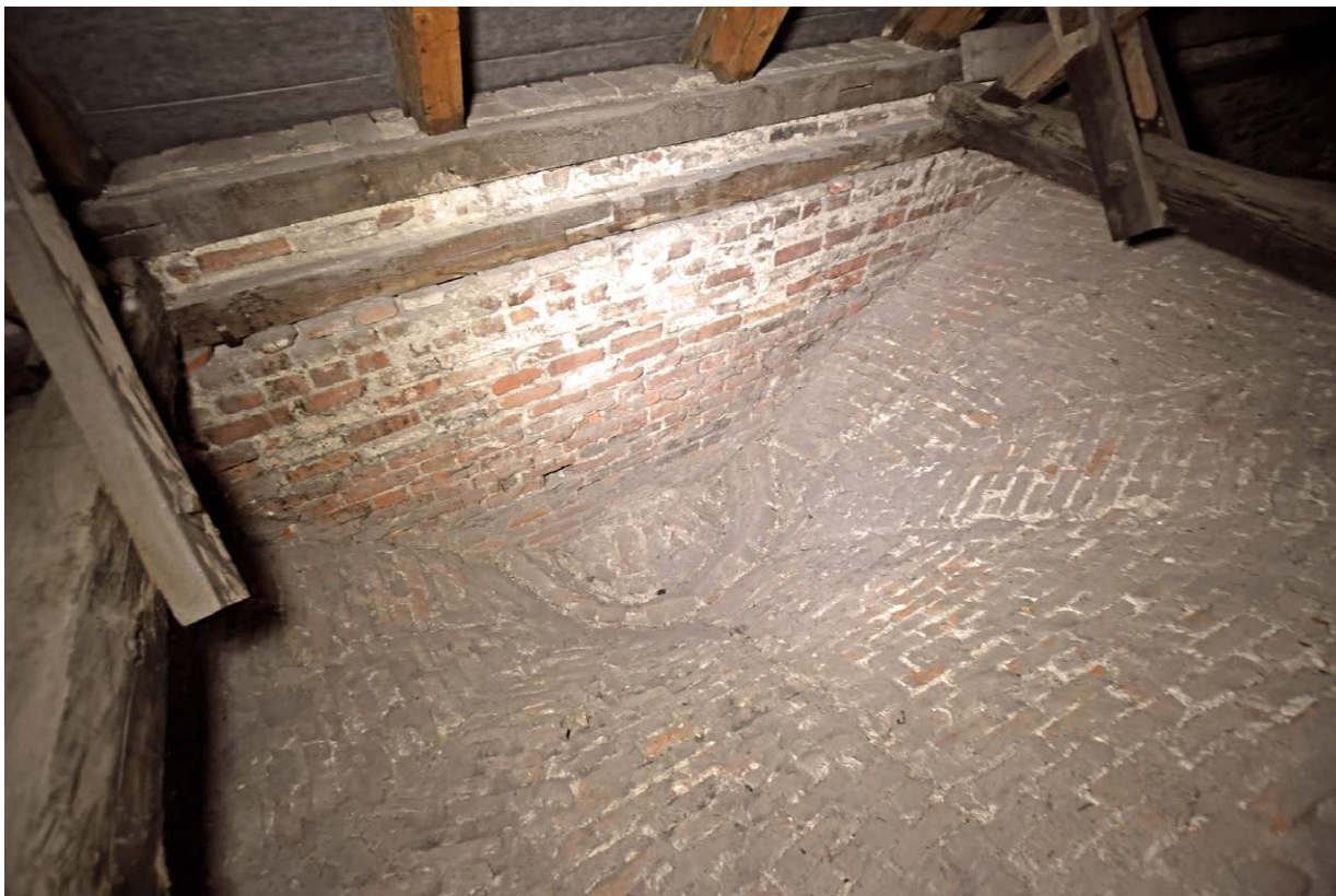
Il. 102. Kościół św. Mikołaja – strych nad nawą północną, pacha sklepienna (2023); fot. F.H.
