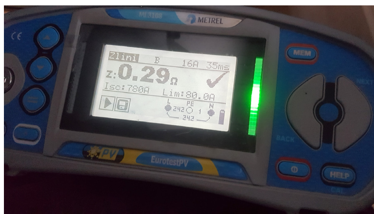
Fot. 7. Pomiar impedancji pętli zwarcia i napięcia instalacji elektrycznej z przyłączoną instalacją fotowoltaiczną o mocy 8 kW; fot. M.M. (2017–2021)
