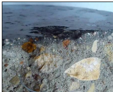
Rys. 2. Fragment rdzenia z odwiertu wykonanego w posadzce nr 3; widoczny odprysk w utwardzonej warstwie wykończeniowej oraz w zewnętrznej warstwie betonu Fig. 2. A fragment of the drill core from the floor no. 3 showing a splinter developed both within its finishing and outer layers
