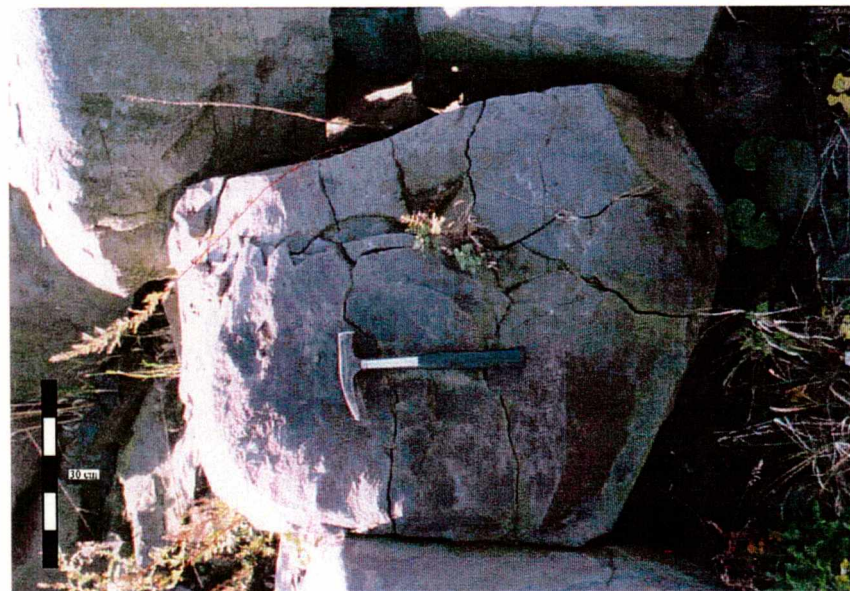
Fot. 8. Nieregularne spękania bloku zgorzelowego zasiedlone przez trawy, wiązówkę bulwkowatą i brzozę (Gronowskie Wzgórze)
