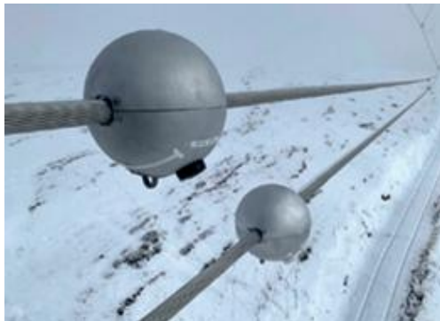
Rys. 9. Czujniki oblodzenia na przewodach wiązkowych linii 380 kV [21]
