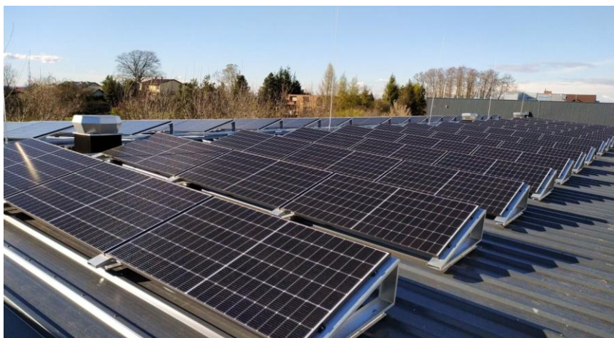
Fot. 1. Przykład ochrony odgromowej instalacji fotowoltaicznej w wykonaniu EL-SUN
