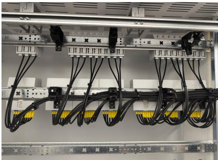
Fot. 2. Przykład ułożenia w powietrzu i wiązkach (zdjęcie wykonane od strony „pleców” rozdzielnicy)
