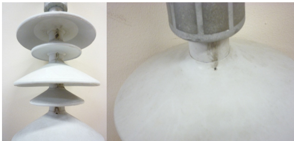
Rys. 11.13. Przebicie kloszy wzdłuż osłony rdzenia
