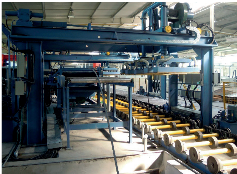
Rys. 2.30. Urządzenie do układania płyt włóknisto-cementowych w stos (Stacker) wraz z systemem przesuwu wózków; fot. T. Gorzelańczyk
