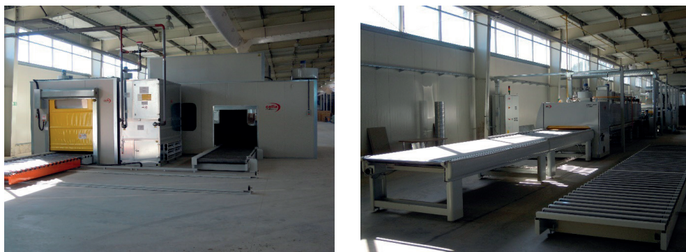
Rys. 2.39. Wybrane urządzenia wchodzące w skład linii lakierniczej; fot. T. Gorzelańczyk
