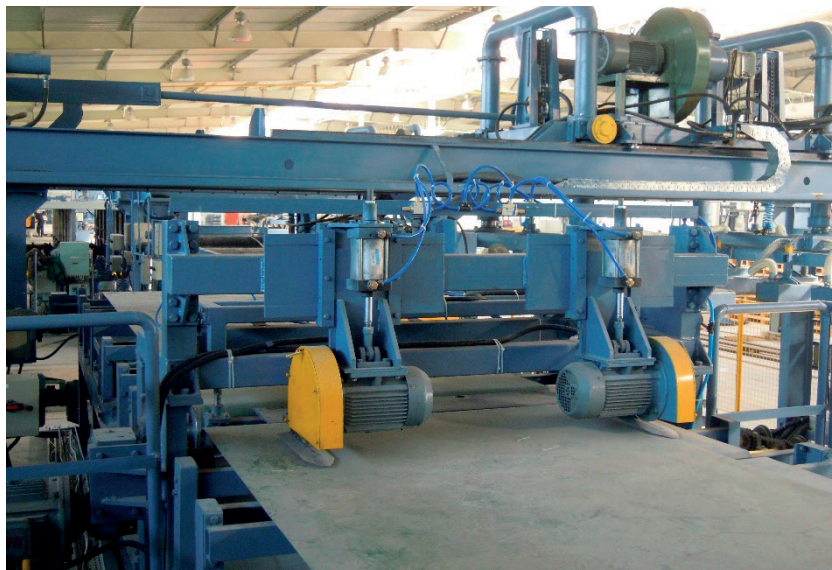
Rys. 2.27. Urządzenie do przycinania krawędzi arkusza płyty i cięcia na mniejsze formaty (w zależności od jej przeznaczenia); fot. T. Gorzelańczyk
