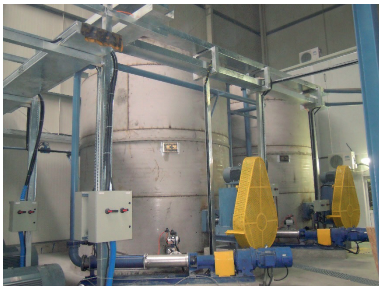
Rys. 2.18. Zbiorniki do przechowywania celulozy z systemem pomp; fot. T. Gorzelańczyk
