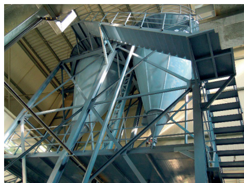
Rys. 2.29. Urządzenie do odzyskiwania wody wraz ze zbiornikiem wody powrotnej; fot. T. Gorzelańczyk
