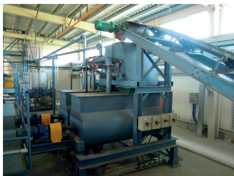
Rys. 2.28. Urządzenie do odzyskiwania odpadów; fot. T. Gorzelańczyk
