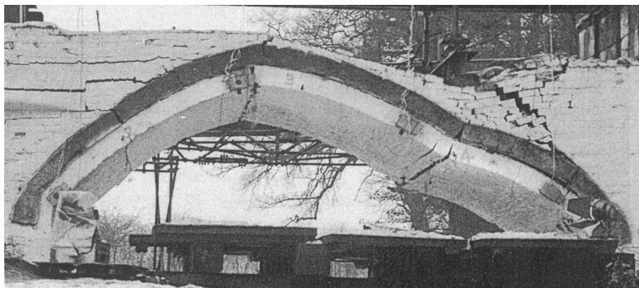
Rys. 6.12. Czteroprzegubowa postać zniszczenia powstałego podczas badań terenowych mostu murowanego – skala naturalna [218]
