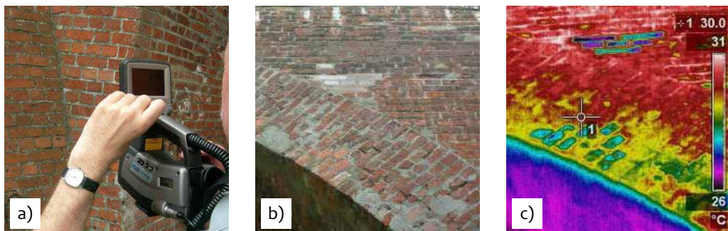
Rys. 4.18. Badanie termowizyjne: a) pomiar kamerą termowizyjną, b) obraz widzialny badanego obszaru, c) uzyskany obraz termograficzny [31]
