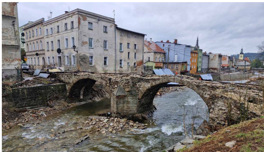
Rys. 7.26. Most św. Jana w stanie uszkodzonym po powodzi (fot. FASYS Mosty)
