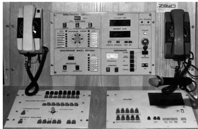
Panel elektroakustyczny w dyspozytorni
