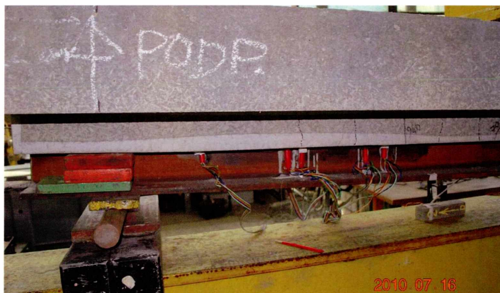
Rys. 4.53 Zarysowanie środnika betonowego w miejscu pracujących łączników po zniszczeniu belki
