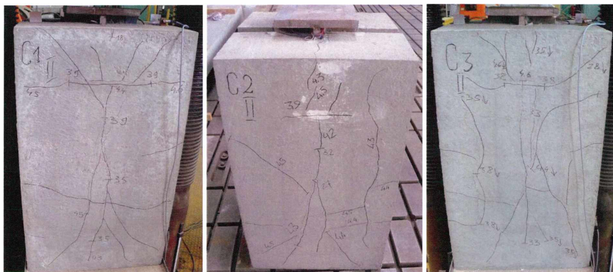
Rys. 4.18 Układ rys na płytach betonowych elementów (od lewej) C/1, C/2 i C/3
