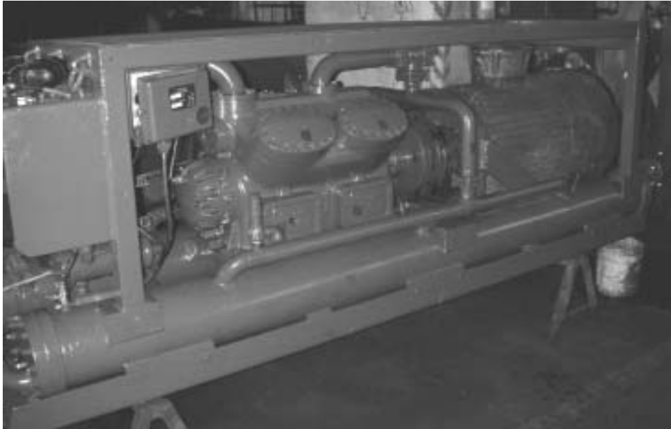
Rys. 13.2. Punkty odniesienia w zespole maszynowym urządzenia chłodniczego DV-290 po remoncie
