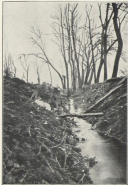
Verwachsener Vorflutgraben nach teilweiser Räumung
