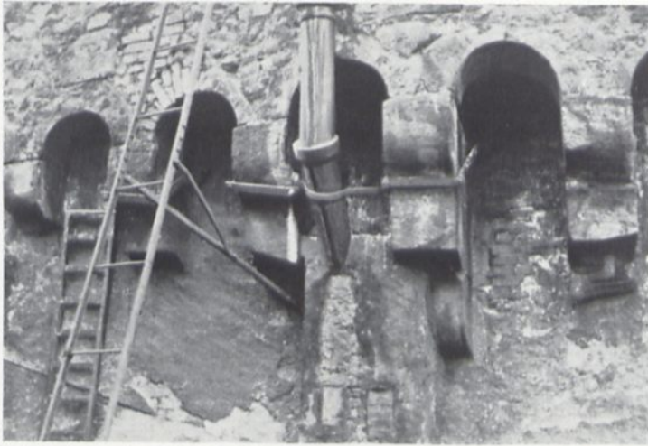
156 Görlitz, Reichenbacher Torturm. Konsolen des Wehrganges vor der Instandsetzung
