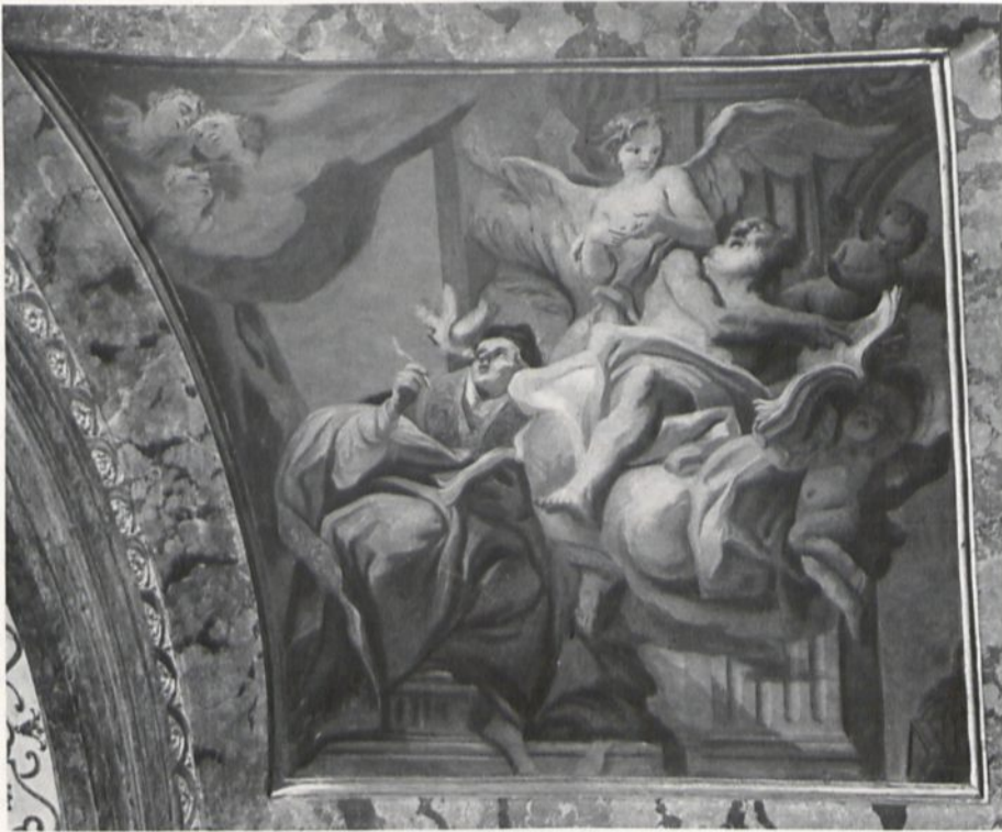
79 Breslau, Kurfürstkapelle Fresko in einem Gewölbezwickel, Gregor und Matthäus, nach der Instandsetzung
