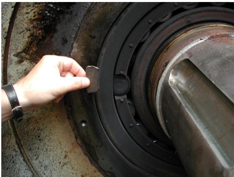
Rys. 3.3. Spalone łożysko silnika pompy wody chłodzącej
