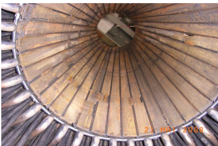
Rys. 11.33. Zdjęcie uszkodzonego stojana silnika pompy 3NK2
