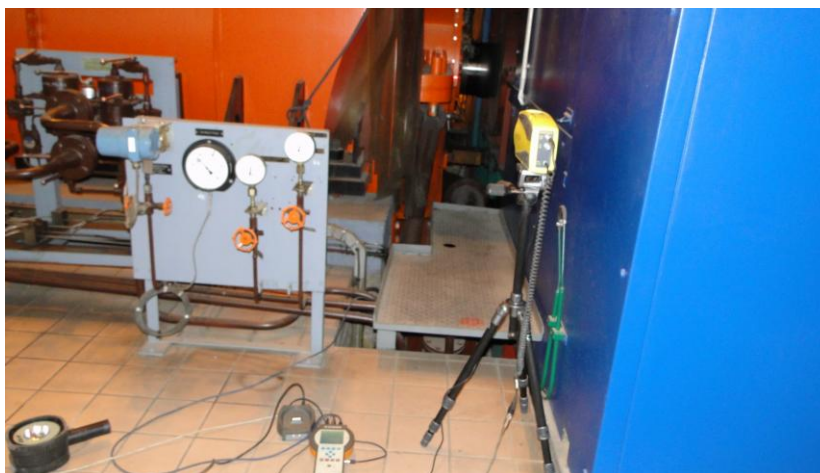
Rys. 12.3. Bezdotykowy pomiar drgań wału generatora GTHW-360
