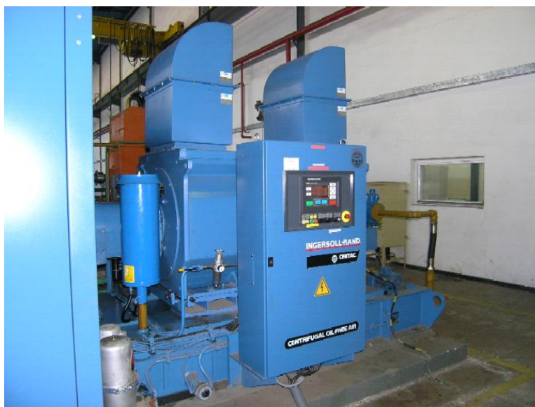
Rys. 11.21. Zespół sprężarkowy z widoczną płytą posadowczą silnika
