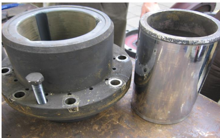
Rys. 11.34. Uszkodzone łożysko poprzeczne i tuleja silnika pompy 3NK2
