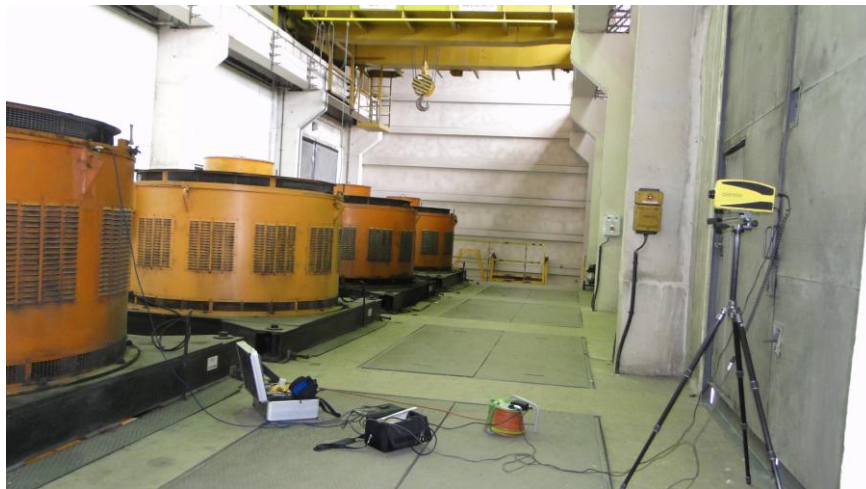
Rys. 12.11. Bezdotkowy pomiar drgań silników pomp wody chłodzącej(SBJVe-1716r, 2000 kW)
