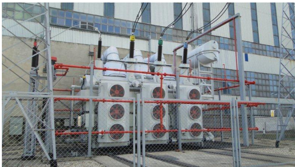
Rys. 12.19. Widok transformatora dużej mocy (blokowego)
