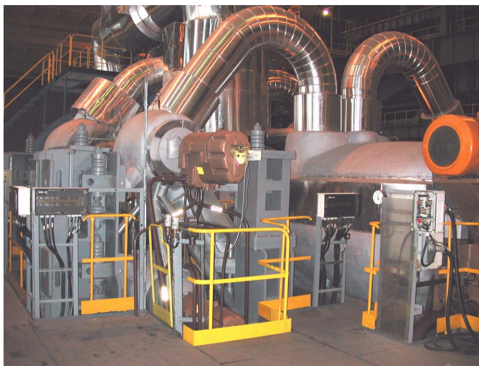
Rys.11.44. Widok zaworów regulacyjnych części WP turbiny
