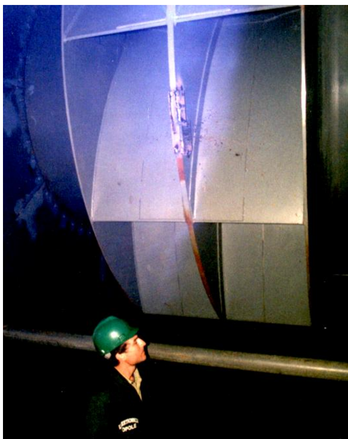
Rys. 10.8. Widok wirnika wentylatora
