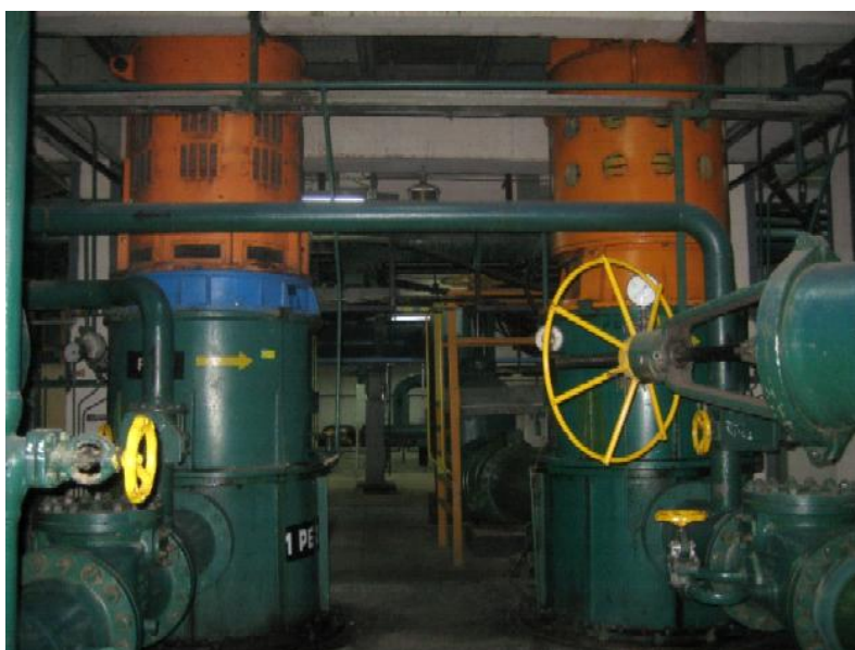
Rys. 11.1. Widok ogólny zespołów pompowych kondensatu
