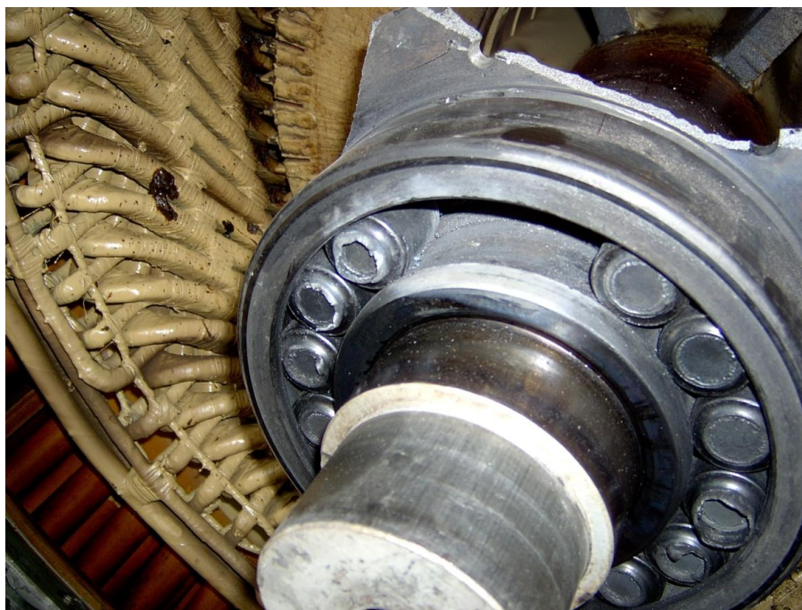
Rys. 3.5. Uszkodzone łożysko silnika wentylatora młynowego
