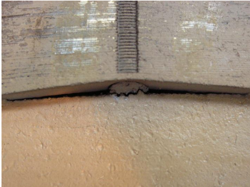
Rys. 11.20. Pęknięcia klatki wirnika – powiększenie
