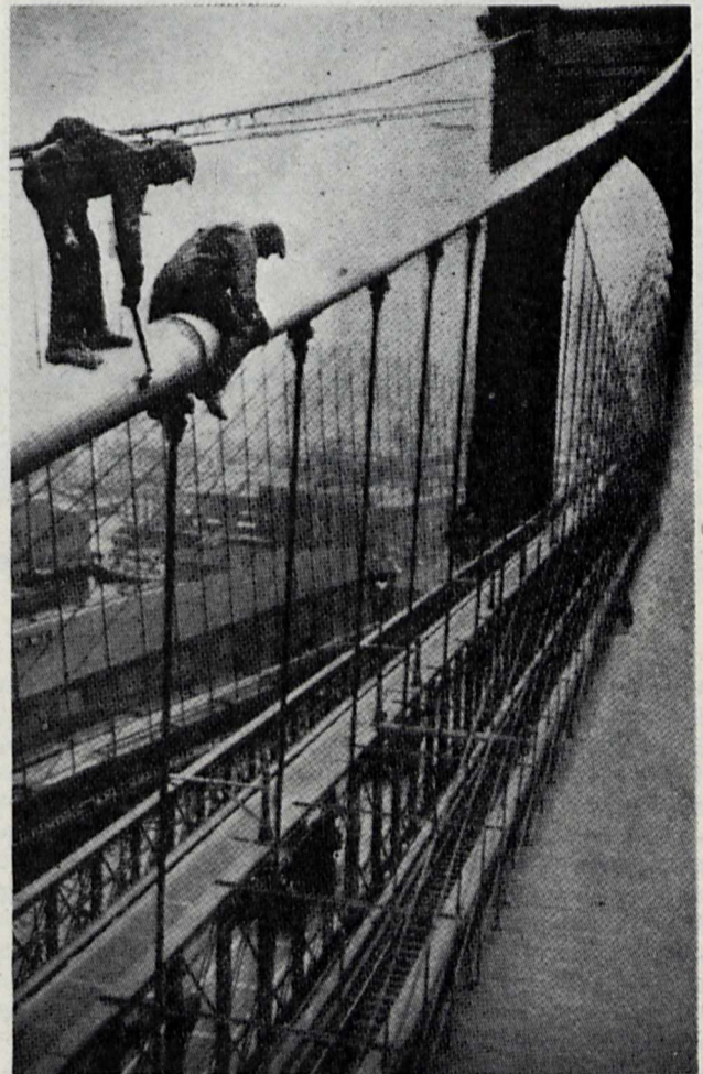
Rys. 4. Mimo znacznych postępów w oszczędzaniu pracy ludzkiej na wielu polach, malowanie mostów odbywa się dziś prawie tak samo, jak przed 50 laty. Znacznie ulepszono materiały, ale prawie żadnego polepszenia niema w ich stosowaniu. Rysunek przedstawia malowanie mostu brooklińskiego, czynność, która posuwa się naprzód prawie bez przerwy w ciągu półwiecza.
