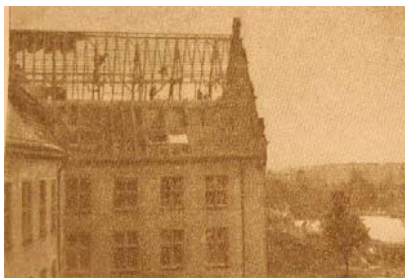
Zniszczony dach budynku A-1
