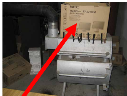
Obudowa wylotu powietrza z nagrzewnicy, do pomiaru temperatur podgrzanego powietrza wylotowego Casing of air outlet from the heater, for meas- urement of hot air temperature at the outlet
