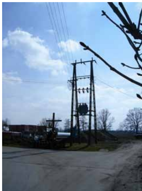
Ryc. 5.86. Współczesne stacje transformatorowe na słupach, Szymanów (gmina Wisznia Mała), 2005
