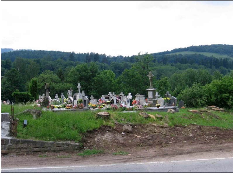
Fot. 32. Wał ziemny wzmocniający skarpe na cmentarzu w Boboszowie – czerwiec 2007 r. (fot. A. Krzemińska)
