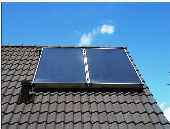
Fot. 7. Dwa kolektory płaskie cieczkowe Vitosol 100
