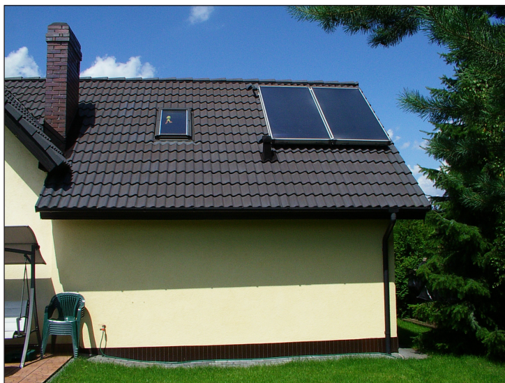
Fot. 6. Widok kolektorów zainstalowanych na południowej pości dachowej budynku
