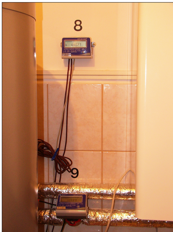
Fot. 13. Widok zainstalowanych ciepłomierzy.
