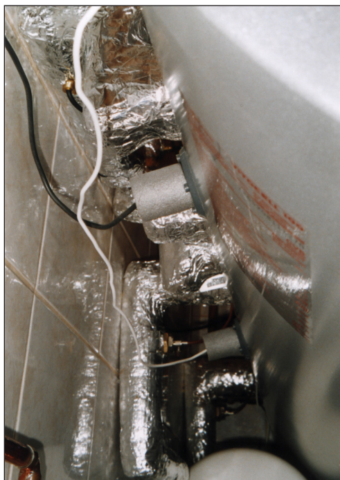
Fot. 15. Wejścia instalacyjne i miejsca zainstalowania czujników temperatury w pojemnościowym dwusystemowym podgrzewaczu ciepłej wody użytkowej Vitocell 100
