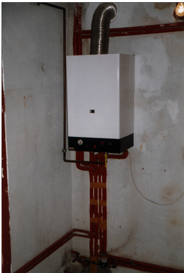
Fot. 3. Widok kotła w kotłowni przed modernizacją
