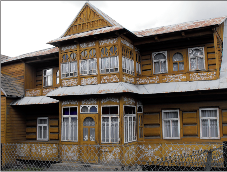
Fot. 5. Widok budynku mieszkalnego we wsi Bialka Tatrzańska z początku XX w. ze zmienionym pokryciem dachowym (fot. autor)
