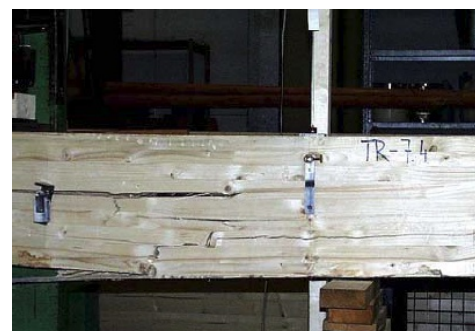
Rys. 3.20. Postać zniszczenia belki z taśmą doklejoną do spodu belki, [13]
