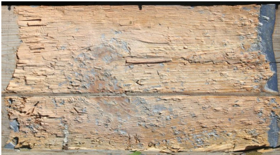
Rys. 4.163. Widok powierzchni belki B1 - po próbie
