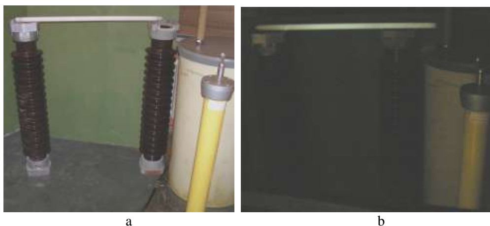
Rys. 14. Świetlówki w polu elektrycznym transformatora 110 kV. a – sposób ułożenia, b – światło widoczne w przyciemnionym pomieszczeniu
