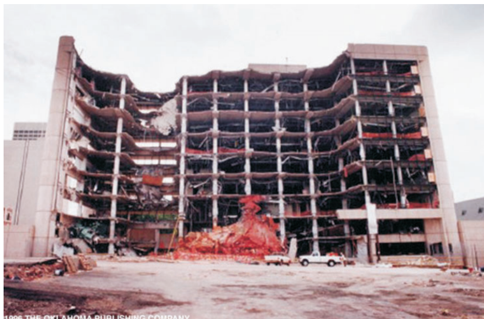
Fot. 4. Zniszczony wskutek zamachu budynek rządowy w Oklahoma City (po uprzątnięciu gruzu, przed wyburzeniem) (The Oklahoma Publishing Co.)
