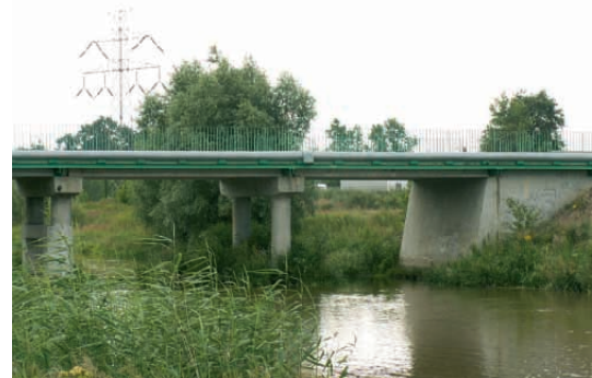
Most Oławski na rzece Oławie w Siechnicach The Oława bridge on the Oława river in Siechnice
