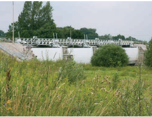
Urządzenia hydrotechniczne na Oławie The hydrotechnic arrangements on Oława river
