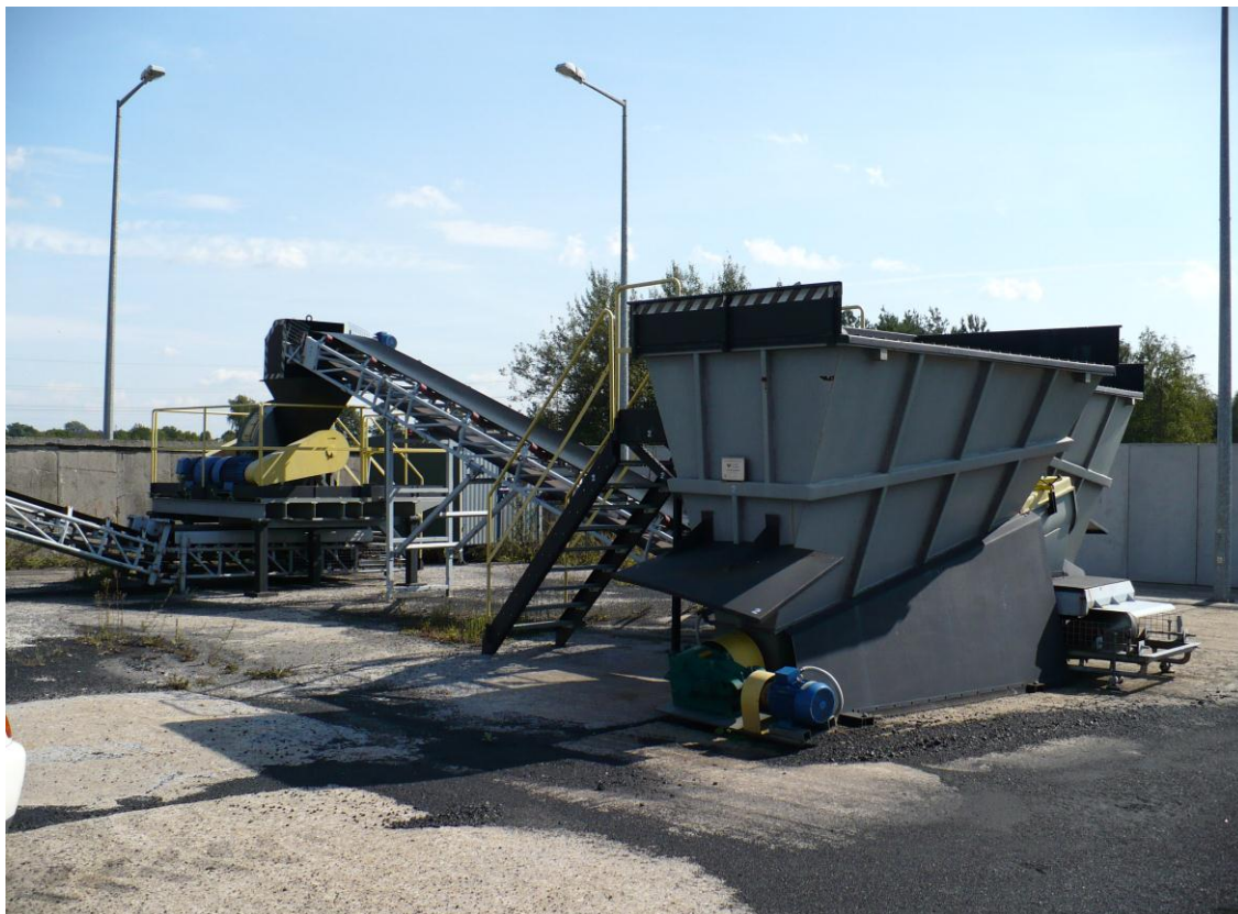
Rys. 4. Stacja mieszania MWD-2 (zdjęcie własne)
