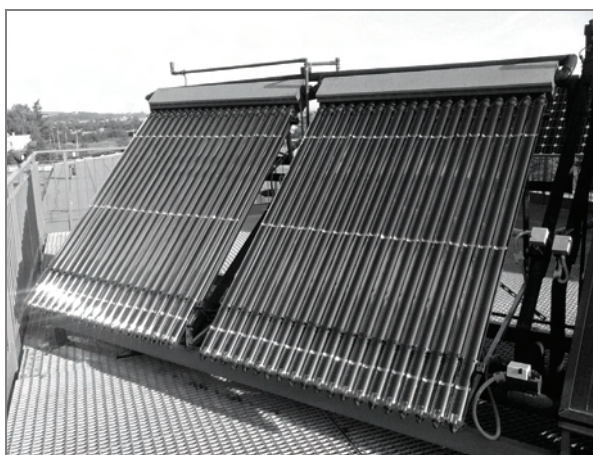
Rys. 2. Zdjęcie kolektorów ETC zainstalowanych na dachu Centrum Odnawialnych Źródeł Energii w Bielawie, fot. P. Pacyga
