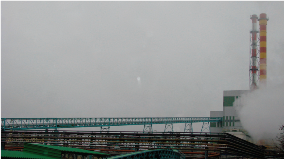
Rys. 4. Przestrzenna kratowa konstrukcja estakady z tradycyjnym przenośnikiem taśmowym biomasy, fot. J. Rządkowski
