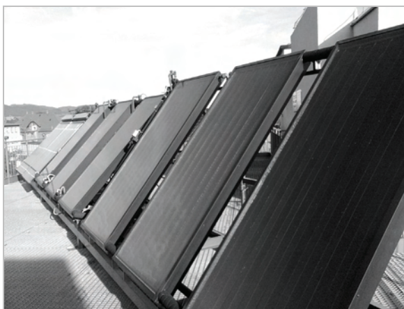
Rys. 1. Płaskie kolektory słoneczne umieszczone na dachu Centrum Odnawialnych Źródeł Energii w Bielawie, fot. P. Pacyga
