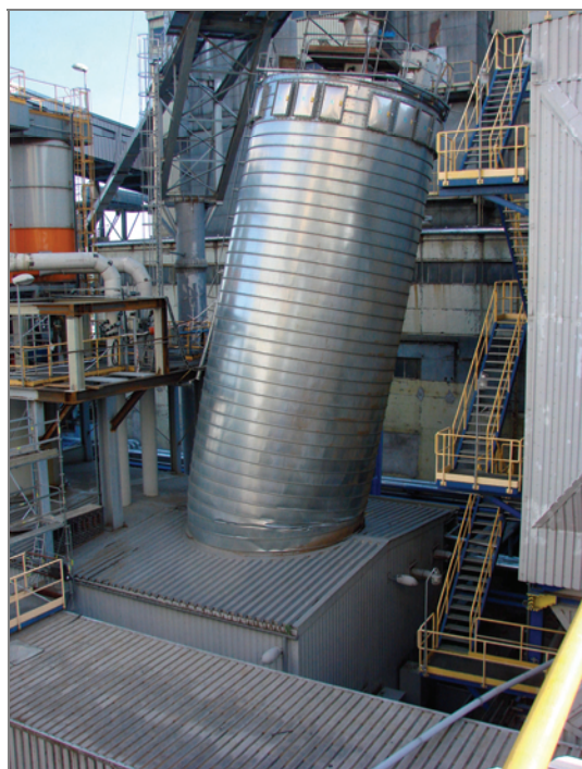
Rys. 3. Awaria zbiornika przykotłowego wskutek niewłaściwego oszacowania obciążenia biomasą, fot. J. Rządowski
