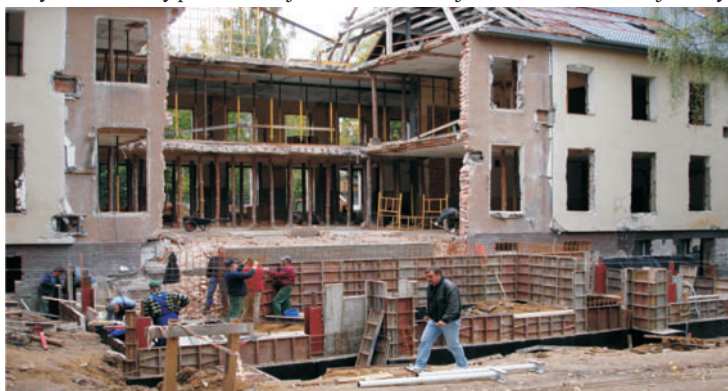
Ryc. 45. Pracownicy Przedsiębiorstwa Budowlanego PEBEX przy budowie fundamentów pod szklaną fasadę budynku nr 13 w dniu 6.10.2006 roku.
