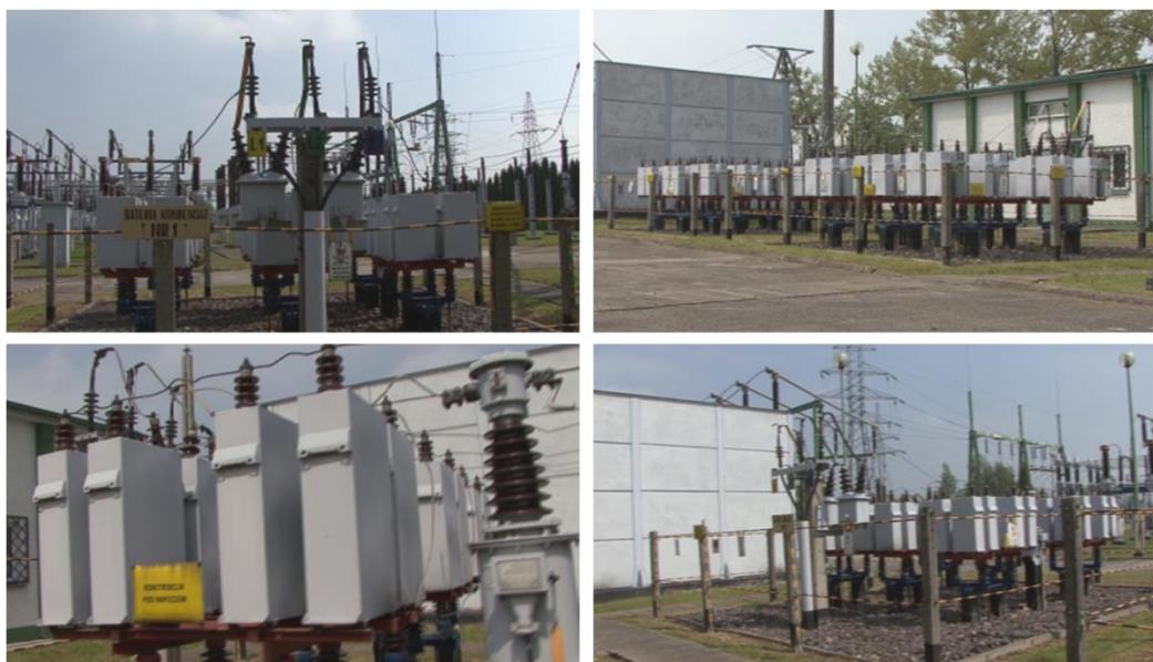
Rys. 7.5 Widok baterii kondensatorów do kompensacji mocy biernej w rozdzielni elektroenergetycznej. Stacja rozdzielcza Nysa-Hajduki, opracowanie własne.
