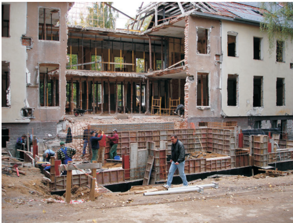
Pracownicy Przedsiębiorstwa Budowlanego PEBEX przy budowie fundamentów pod szklaną fasadę budynku nr 13 w dniu 6.10.2006 roku. Na pierwszym planie kierownik budowy inż. Jacek Lewandowski
