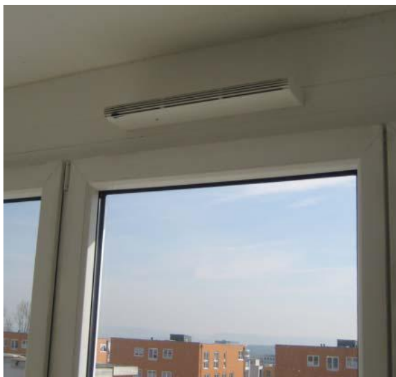
Rys. 5-25: System wentylacji mechanicznej w obiekcie testowym.
