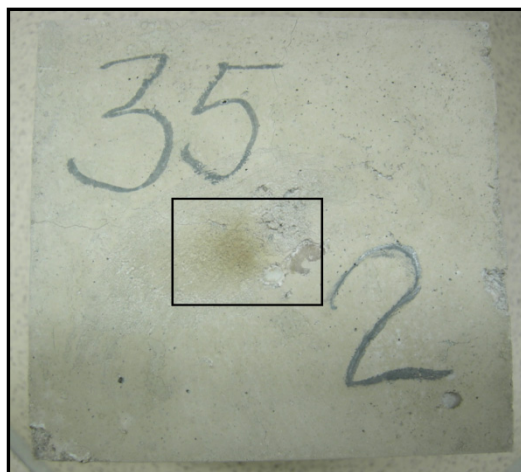
Rys. 7.9. Beton z dodatkiem odpadu niebezpiecznego na spoiwie CEM I+40%PF+GO po wyprażeniu w temperaturze 400°C z widocznym w środku przypaleniem Źródło: badania własne.
