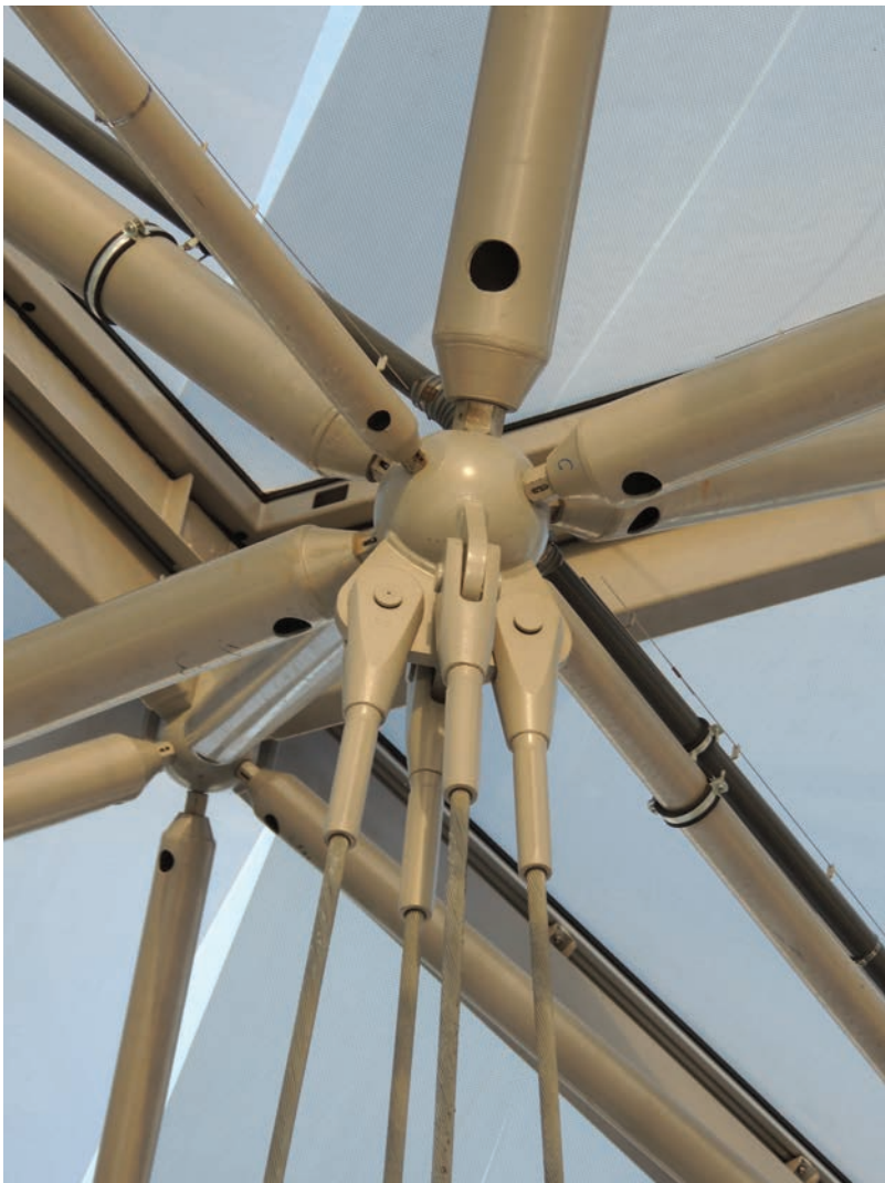
Zadaszenie „Vela” przy wieżowcu Torre Unipol w Bolonii – szczegół zamocowania cięgien (arch. Open Project Office, konstr. M. Majowiecki) (fot. M. Majowiecki)
