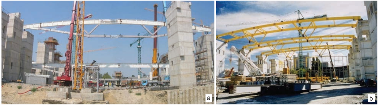
Il. 7. Konstrukcje hybrydowe na terenach targowych w Bolonii: a) pawilon 16-18, b) pawilon 19-20
