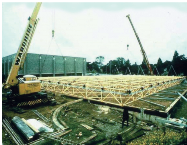
Il. 6. Nodus Centre (Uniwersytet w Surrey) w trakcie budowy, 1972 (źródło: Space Structures Research Centre Archives, University of Surrey)
