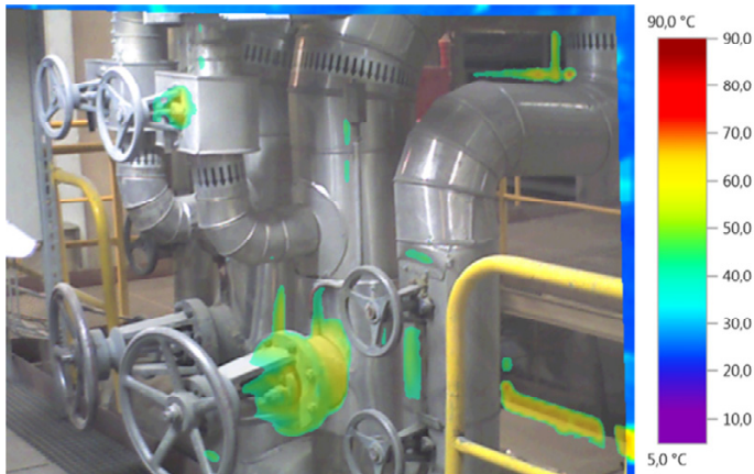
Rys. 9. Zawory zamykające odwodnienie rur opadowych i odwodnienie parownika kotła
