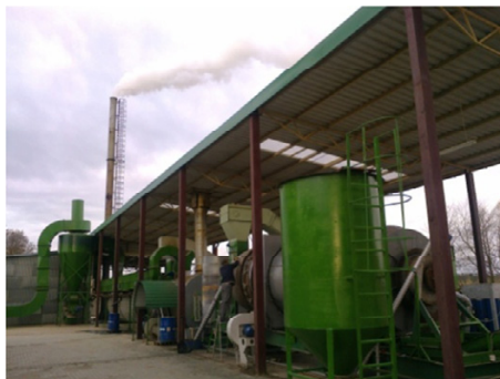
Rys. 3. Instalacja zgazowania biomasy, na której przeprowadzono próby zgazowania odpadów komunalnych
