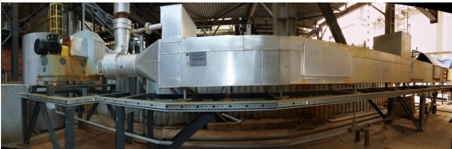
Rys. 2. Widok instalacji pilotowej do badania odzysku ciepła odpadowego ze spalin
