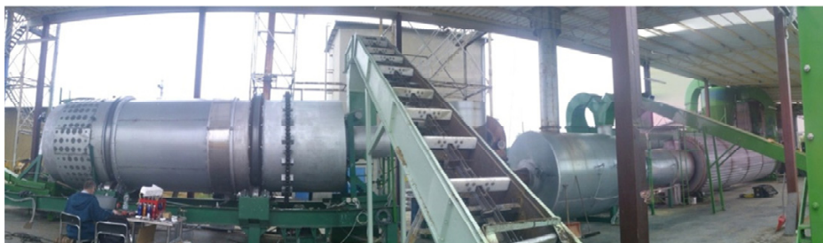
Rys. 1. Widok instalacji zgazowania
