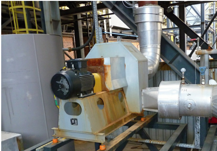
Rys. 5. Wentylator wspomagający zamontowany na stanowisku badawczym
