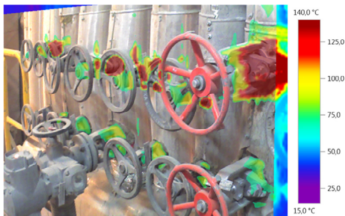
Rys. 8. Zawory zamykające odwodnienia kotła
