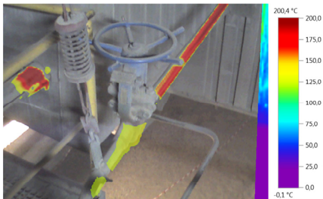
Rys. 7. Zawór zamykający odwodnienie głównej komory ściany tylnej kotła
