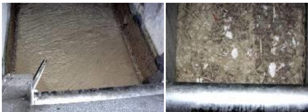
Rys. 3-4. Ścieki na kracie schodkowej
