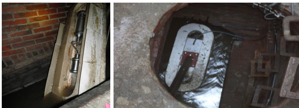
Rys. 3. Lokalizacja sond on-line firmy Hach-Lange umieszczonych na pływaku (pontonie) w burzowcu w systemie kanalizacji ogólnospławnej w Łodzi [fot. własna]
