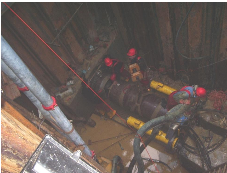
Rys. 1. Przykład komory startowej na budowie kanalizacji w okolicach lotniska we Wrocławiu (zdjęcie własne)
