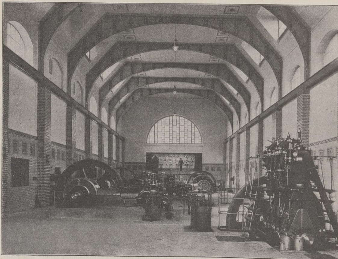
Abb. 26. Maschinenhalle des Maschinenlaboratoriums. Blick nach der Schalttafel.
