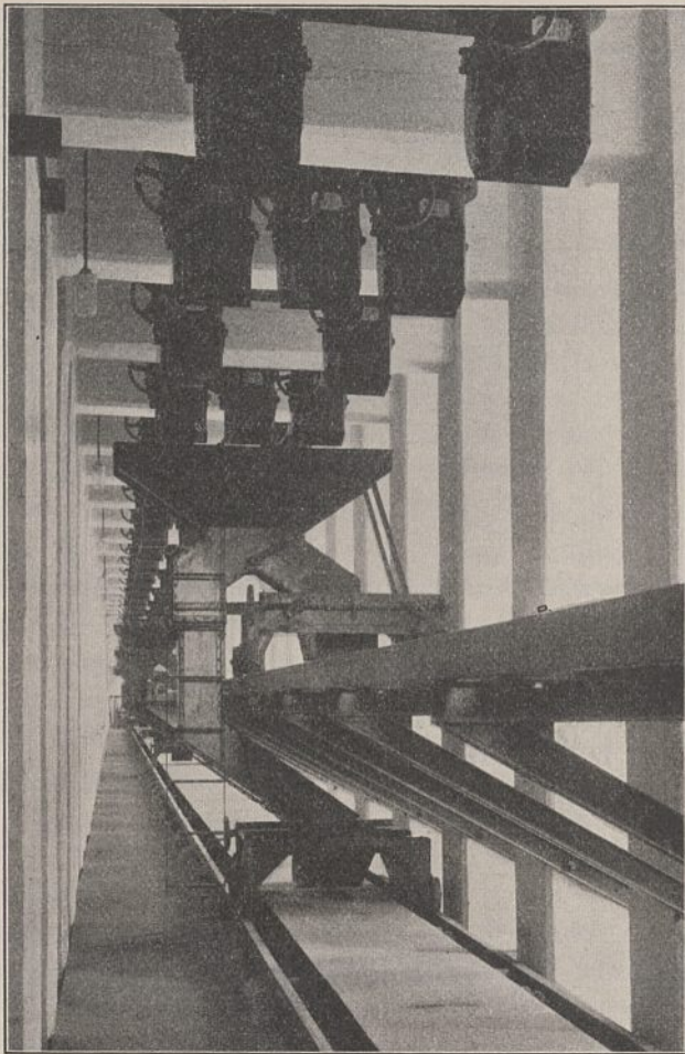
Abb. 1. Bandförderer unterhalb der Silozellen.
