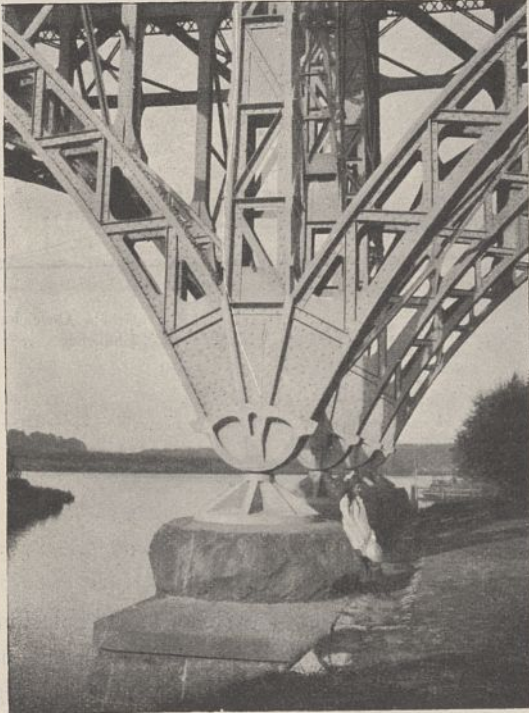
Abb. 16. Festes Lager auf dem Mittelpfeiler C.
