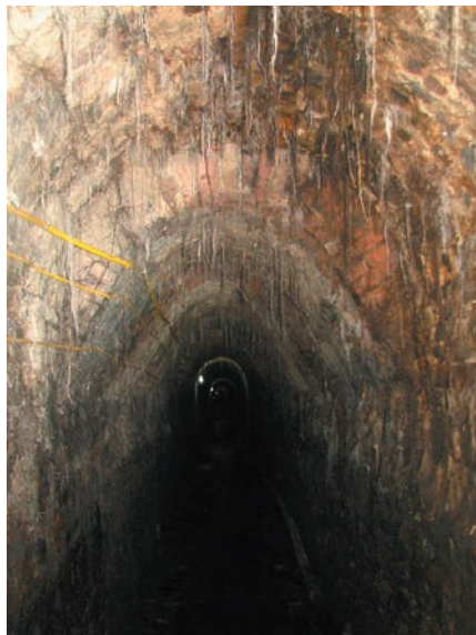
Ryc. 4. Korzenie drzew przerastające obudowę kamienną wyrobiska (Główna Kluczowa Sztolnia Dziedziczna w Zabrze)
