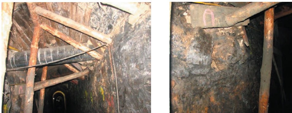
Ryc. 5. Zniszczenie ociosów związane z wzrostem obciążenia obudowy spowodowanego robotami ziemnymi prowadzonymi w bezpośrednim sąsiedztwie wyrobiska (Główna Kluczowa Sztolnia Dziedziczna w Zabrze)
