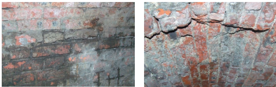
Ryc. 3. Ubytki lica cegły oraz ubytki zaprawy w spoinach spowodowane przemarzaniem obudowy Kopalni Ćwiczebnej „SztYGarka” w Dąbrowie Górniczej
