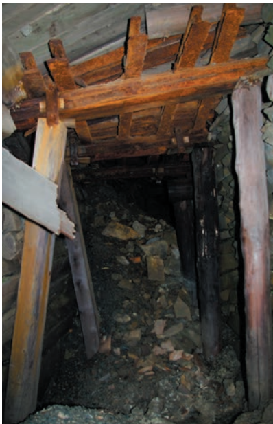
Ryc. 4. Wnętrze sztolni nr G2b- \alpha z dobrze widocznym sposobem zabezpieczenia ociosów i stropu
