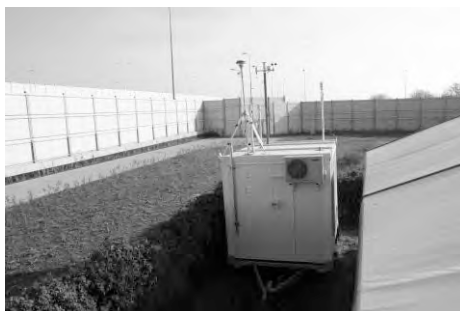
Rys. 6. Usytuowanie kontenera pomiarowego
