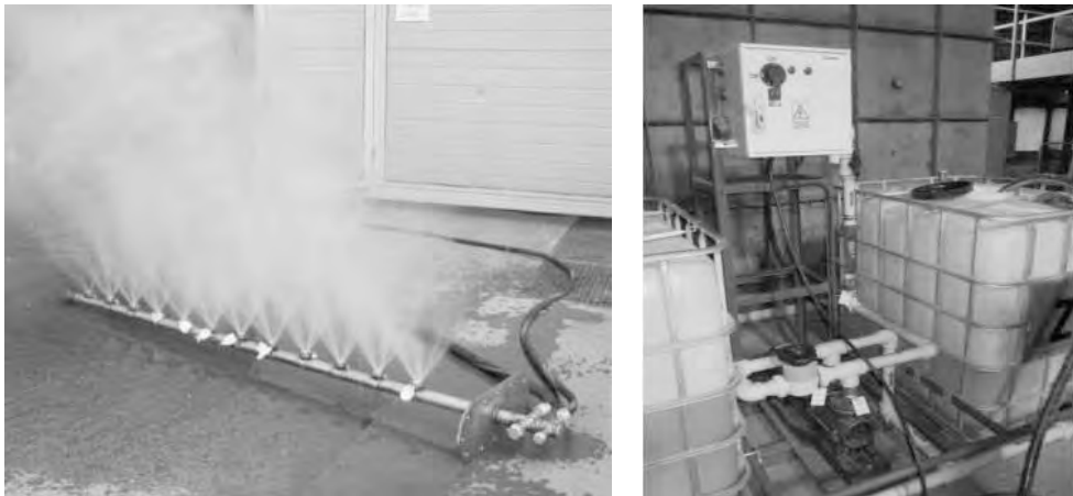
Rys. 7. Lanca z dyszami dwuczynnowymi. Instalacja przygotowania i dozowania addytywów
