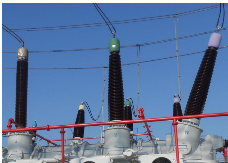
Rys. 3.1. Widok izolatorów przepustowych WN zamontowanych na transformatorze
