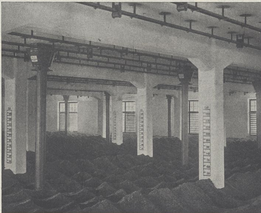
Abb. 8. Abgerieseltor Boden im Haferspeicher des Königl. Proviantamts in Ulm.
