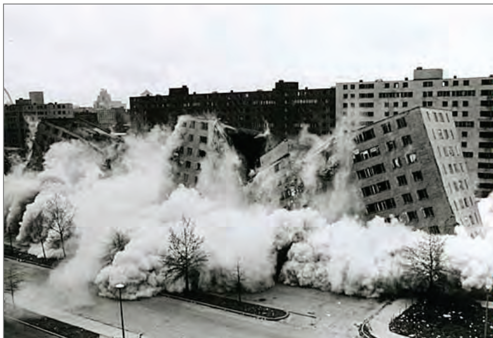
Il. 2. St. Luis, USA, rok 1972. Wyburzenie pierwszego z 33 budynków stojących w kompleksie Pruitt Igoe 5
